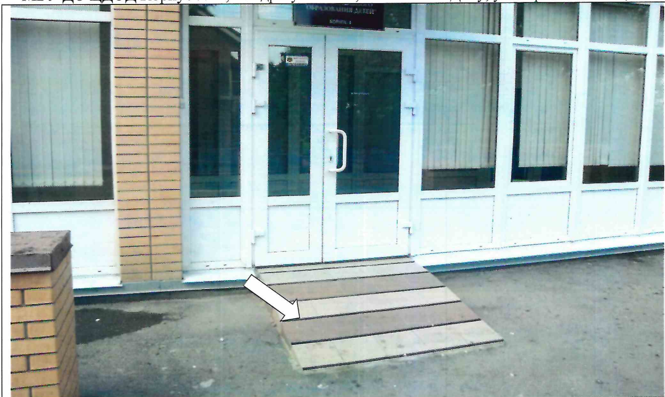
Фото № 3. Перепад высоты сглажен пандусом. Нет входной площадки. Дверной проем и дверная ручка неконтрастны.
