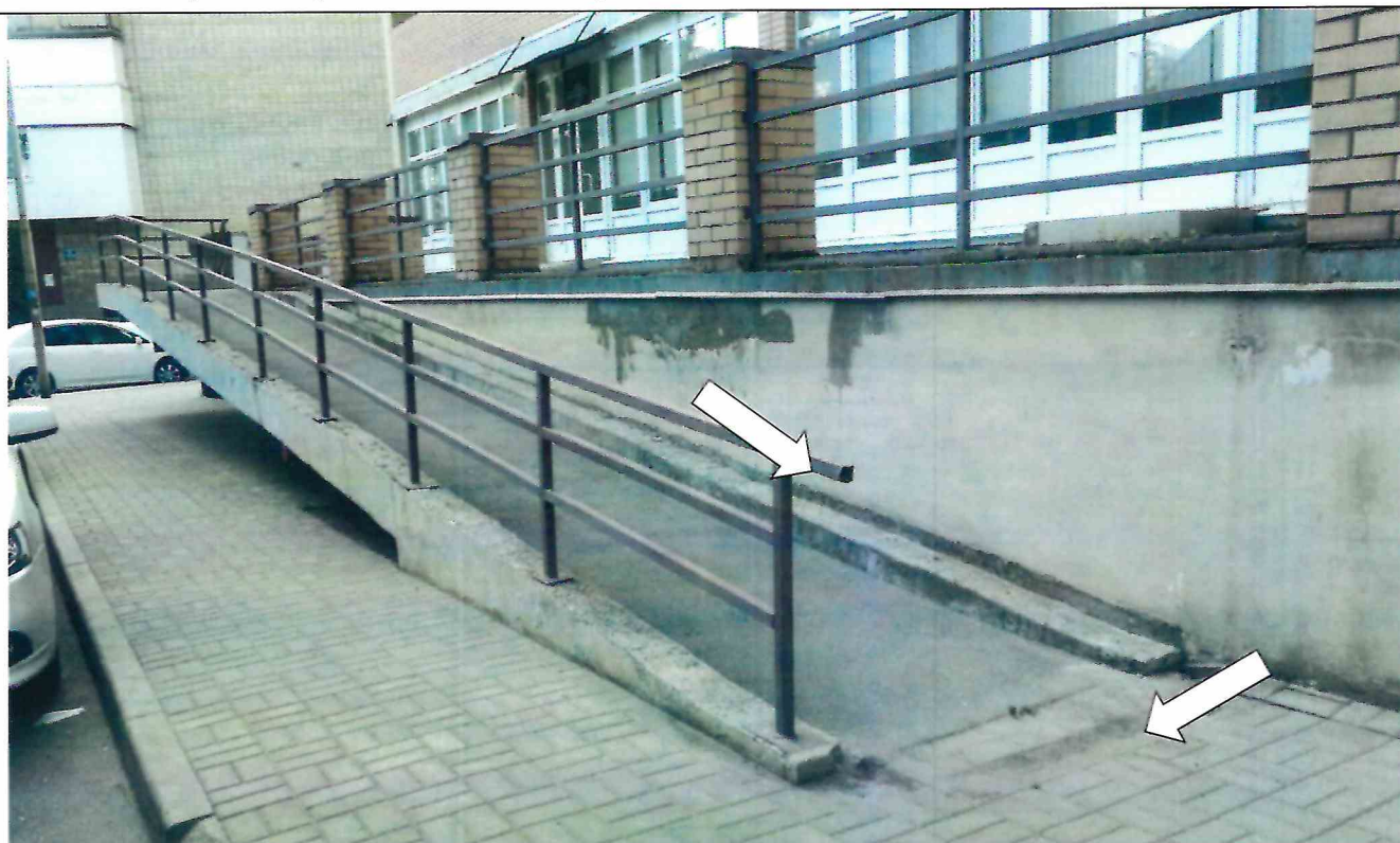
Фото № 2. Поручень установлен с одной стороны марша пандуса, имеет травмирующее завершение. В нижней части пандуса горизонтальная площадка имеет неровности.
