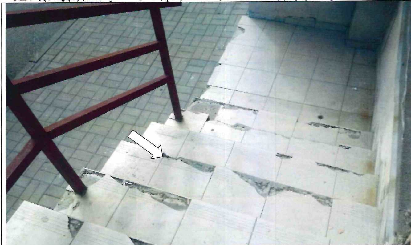
Фото № 9. Покрытие ступеней лестницы имеет неровности, нарушение целостности.
