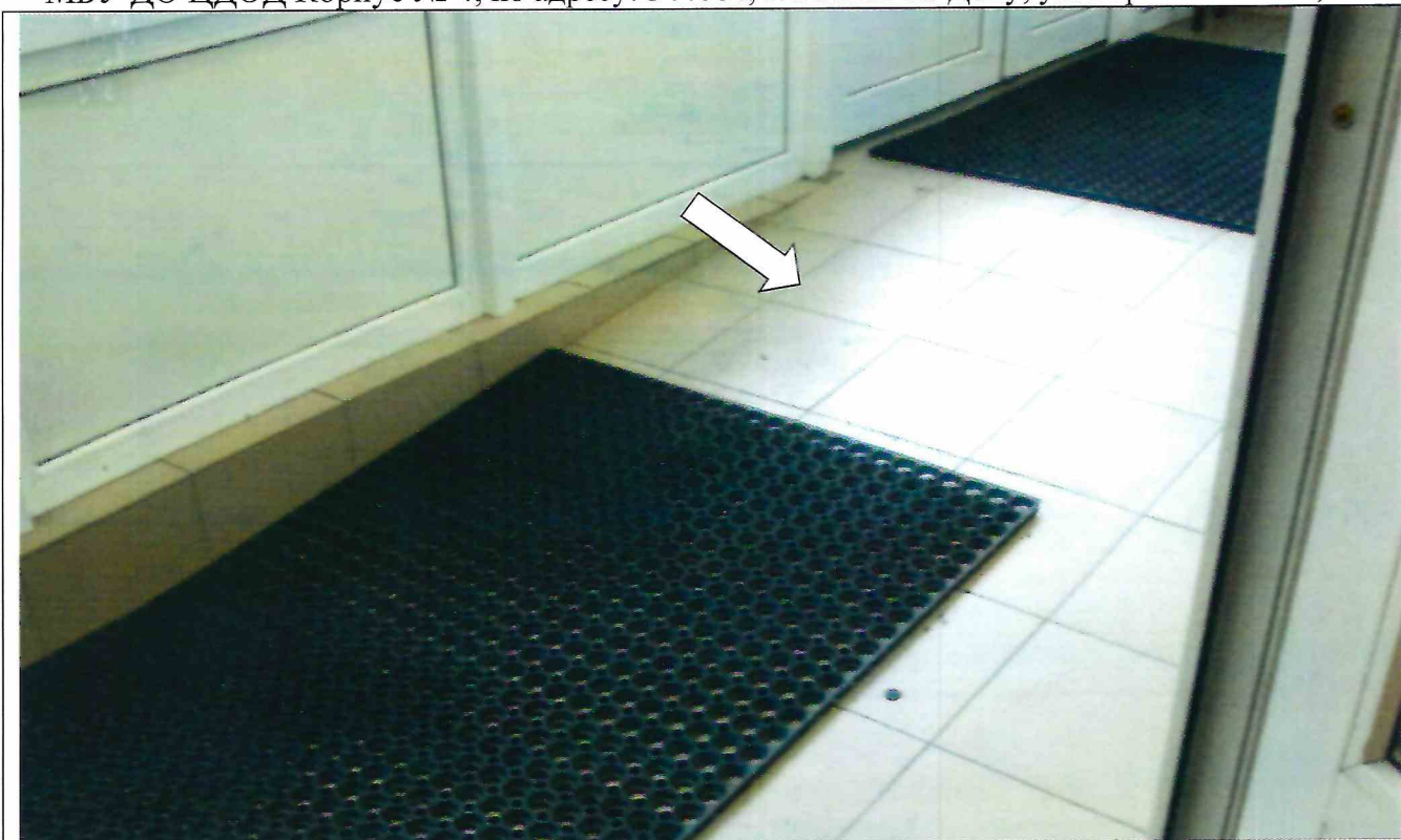
Фото № 5. Перепад высоты в тамбуре сглажен пандусом. Покрытие поверхности пола тамбура скользкое при намокании. Уложены грязезащитные коврики незакрепленные по краям.
