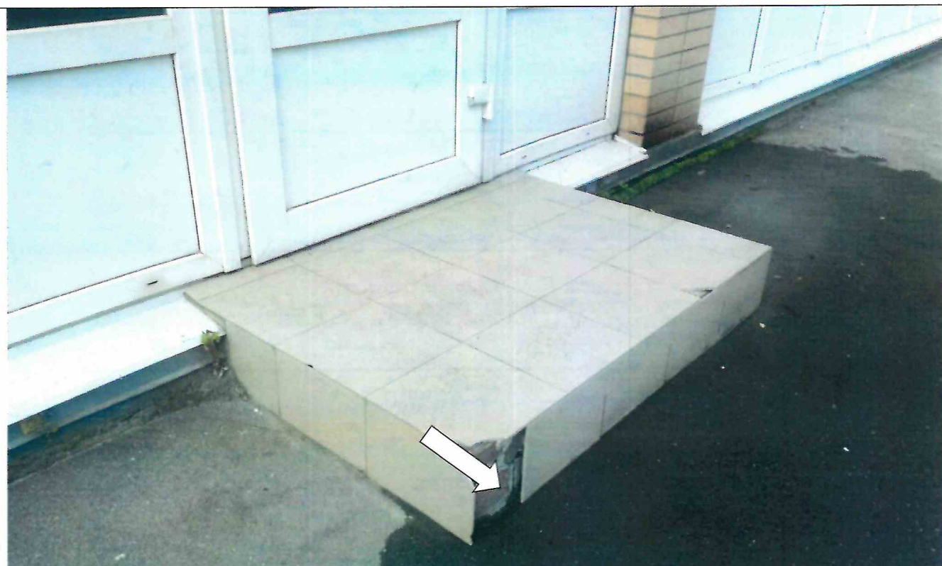
Фото № 4. Покрытие входной площадки имеет нарушение целостности.
